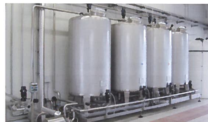
Fig. 13.37 - Impianto esterno C.I.P. (Progema Engineering S.r.l.).
