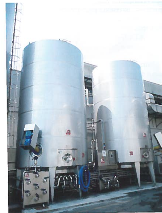
Fig. 7.2 - Serbatoi coibentati per lo stoccaggio di zucchero (ADUE SpA).
