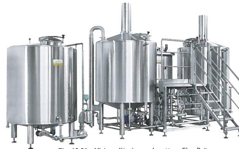
Fig. 12.21 - Visione d'insieme sala cottura Flex-Bräu con serbatoio acqua calda 10-20 [hl] (Impiantinox Srl).
