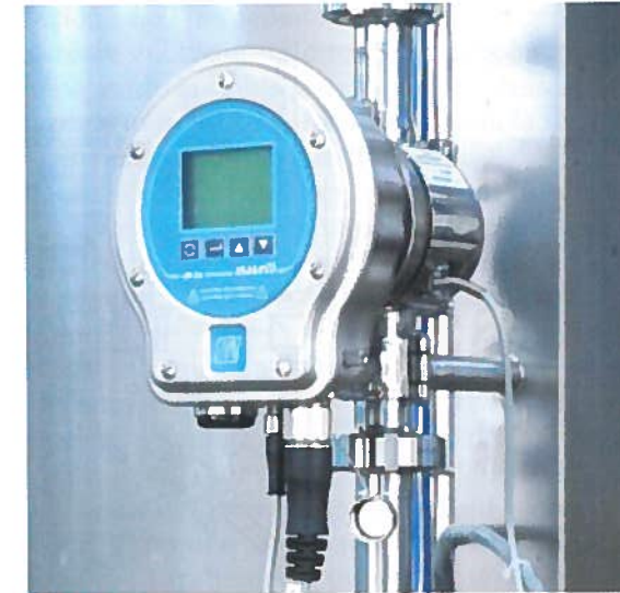
Fig. 5.29 - Rifrattometro di processo (Maselli Misure su impianto ADUE SpA).
