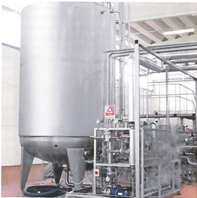
Fig. 7.3 - Serbatoio asettico zona di riempimento per industria alimentare (ADUE SpA).
