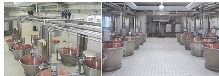
Fig. 13.33 - Doppifondi di cottura. Visualizzazione di 2 file adiacenti (Progema Engineering S.r.l.)
