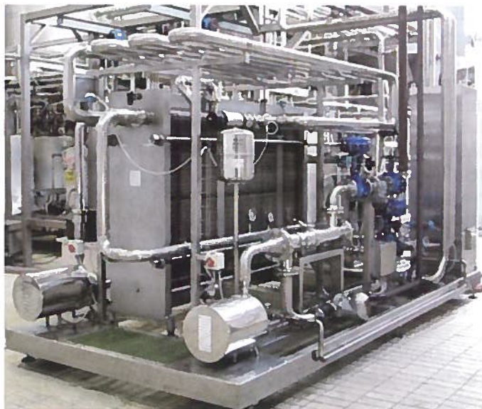
Fig. 7.27 - Impianto di sterilizzazione a piastre per succhi "Olympic P" (CFT S.p.A).
