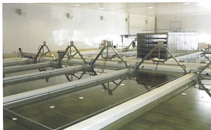
Fig. 13.35 - Piscine per la salazione ad immersione (Progema Engineering S.r.l.).
